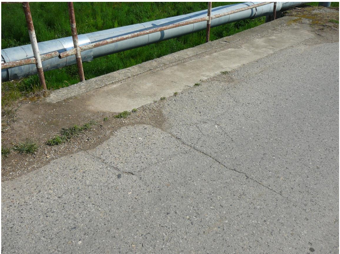
16. Pohľad na trhliny vo vozovke a znečistenie okrajov
