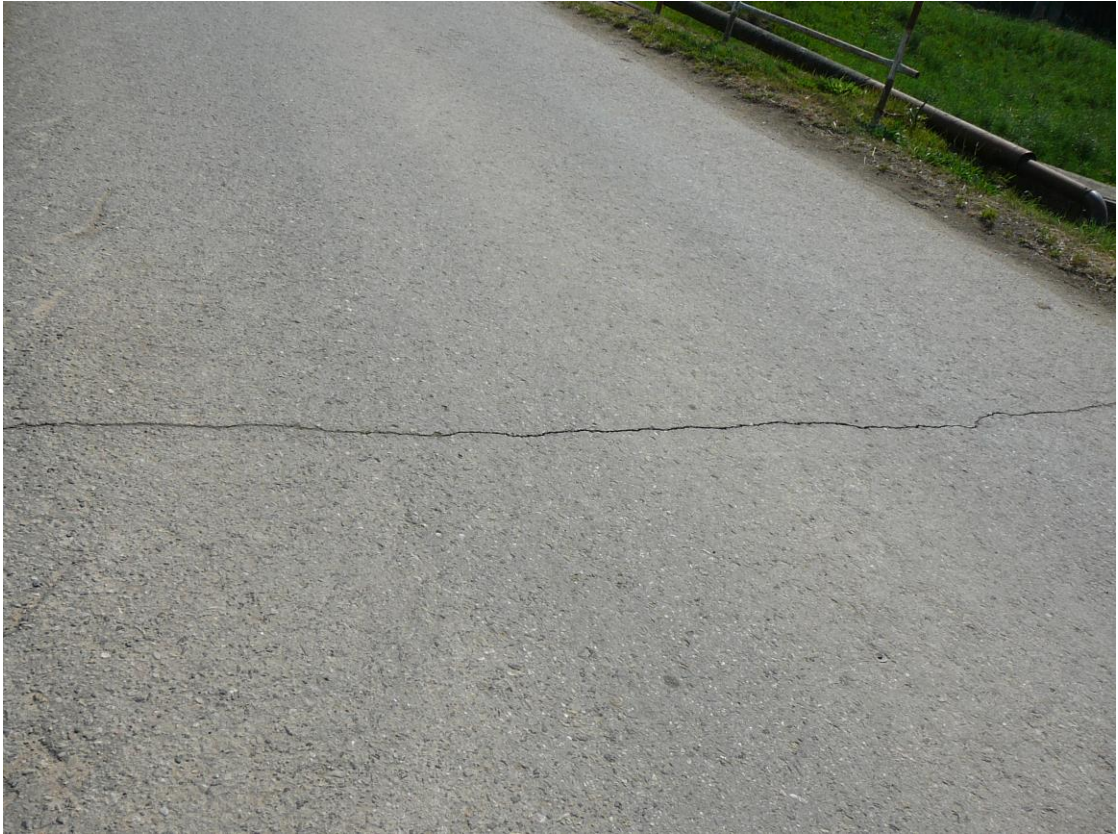
15. Pohľad na priečnu trhlinu vo vozovke
